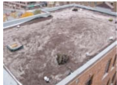
Figure 9 : Toiture végétale du 850, Salaberry
